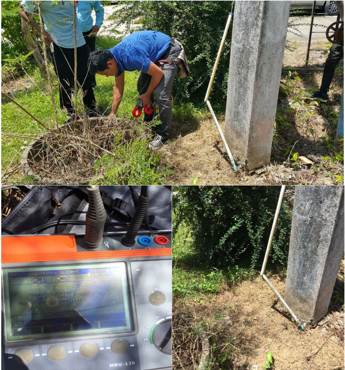
รูปที่ ๓.๒ การตรวจวัดค่าความต้านทานดินของเสาสูงเก็บน้ำประปา
